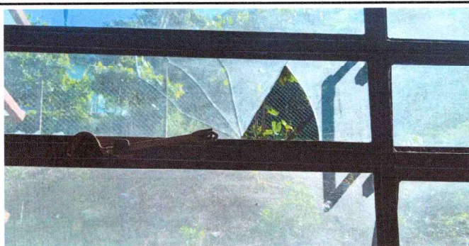
Foto 3: Se observa el deterioro del vidrio de las ventanas de la escuela del modulo 1.
