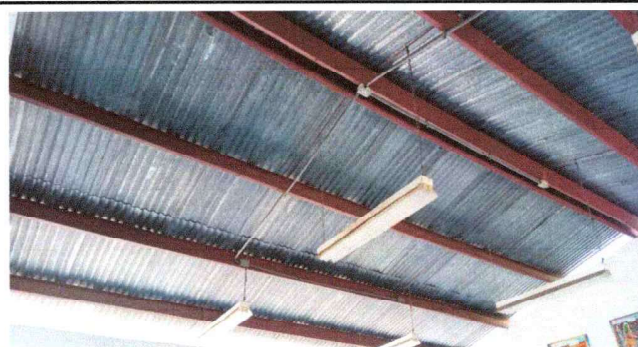
Foto 4: Se observa la falta de cielo falso de las aulas de la escuela del modulo 1.
